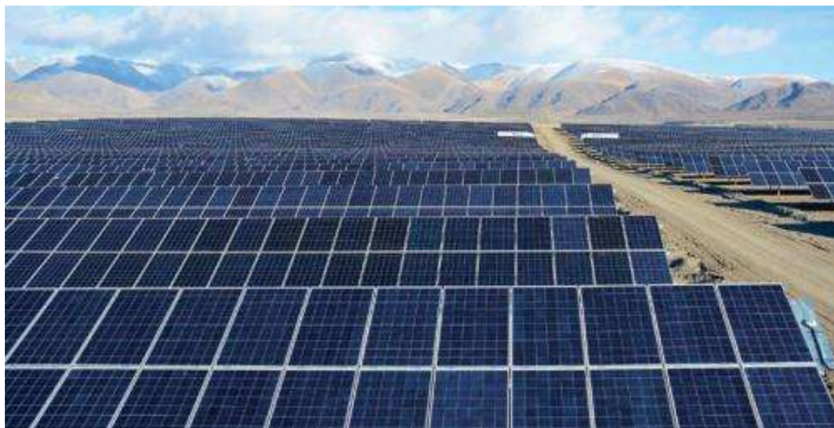
Рисунок 2 – Крупнейшая солнечная электростанция на Алтае (Россия)
